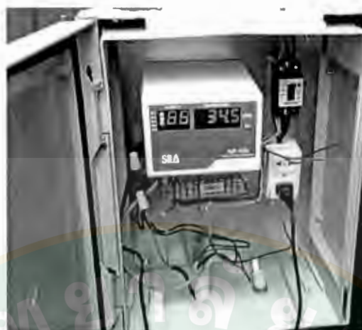
ภาพที่ 17 ตู้ควบคุม
